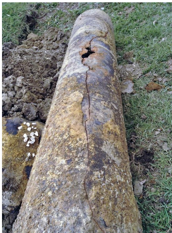
Fuite sur fonte grise
