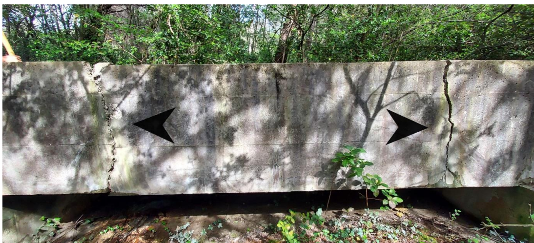
Affaissement du canal principal
