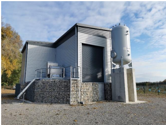
Station de pompage de la Poulatte
